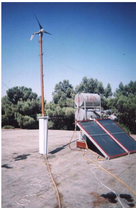
Рис.1 Общий вид экспериментальной установки (СВП+ВЭА), заблокированной с ЦЭС
